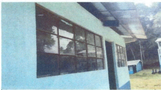
Foto 4: Vista frontal del instituto en donde se puede observar que el módulo II, necesita balcones para brindar seguridad al establecimiento.
