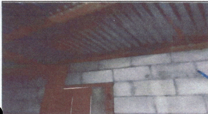
Foto 1: Se evidencia en entechado del establecimiento donde se refleja el mal estado en que se encuentra las costaneras y láminas del Módulo I
