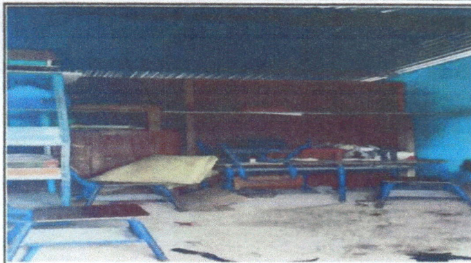
Foto 2: Se observa claramente la necesidad de la rehabilitación de la división del modulo II, ya que actualmente brinda poca seguridad a la población estudiantil.
